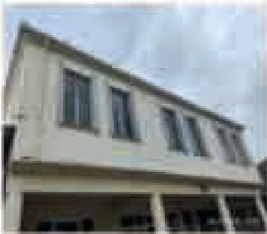
Hüsnü Dışkapı Mahallesi'nde Bulunan Hizmet Binasının Çatısında Yapılan Bakım Ve Onarım Çalışmaları
